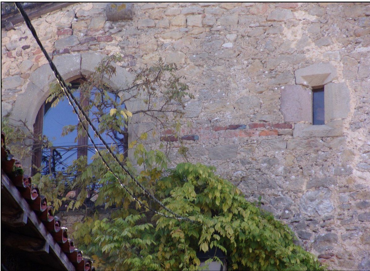
Doc. 56. Porte et fente d'éclairage à chanfrein au second étage. Les deux lits de briques visibles correspondent au trou de la barre de bois qui servait, en coulissant, à fermer solidement la porte. Photo S.A.
